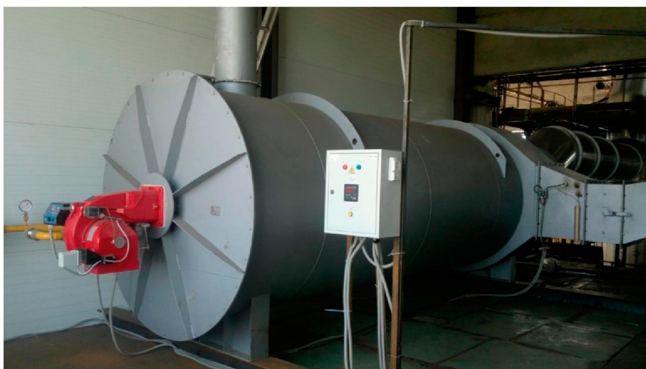
Рисунок 2 Газовый теплогенератор ТВГ-2,2 тепловой мощностью 2,2 МВт.
